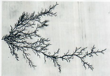
Bild 4: Beispiel einer Dendriten-Bildung (verästelter Fortsatz) an einem Isolator entlang der Kriechstrecke.
